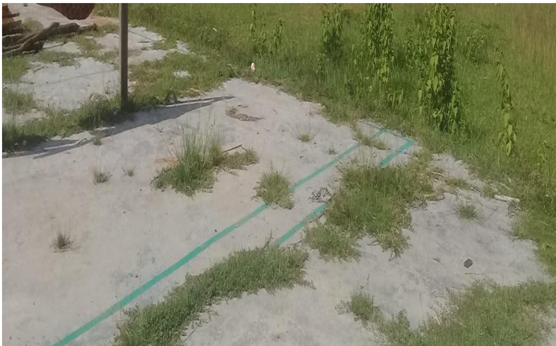
DOKUMENTASI BUKTI KEMUNDURAN GEDUNG ASRAMA YANG DIBONGKAR
