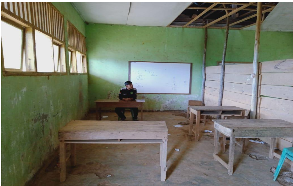
*Kondisi Gedung Sekolah SDN 129 Kaur
